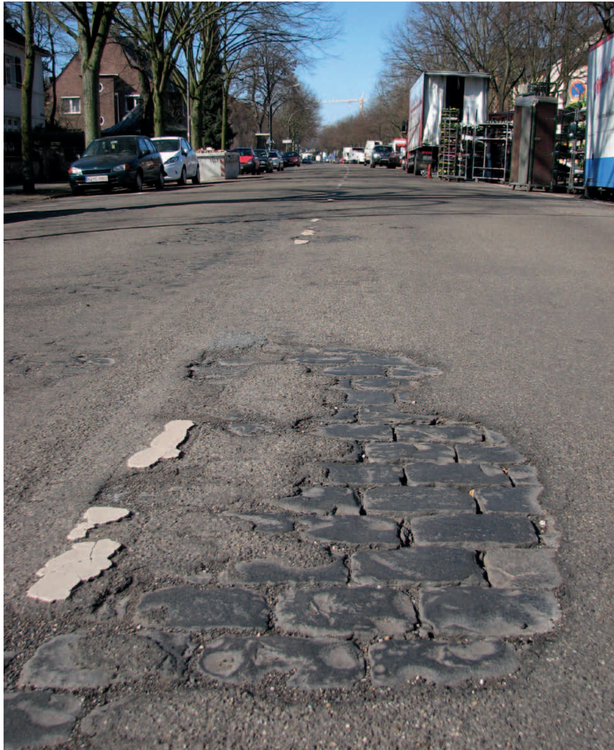
Nach dem Frost: Ob sich Flickschusterei lohnt oder besser der gesamte Belag erneuert wird, kann ein PMS mitentscheiden.
